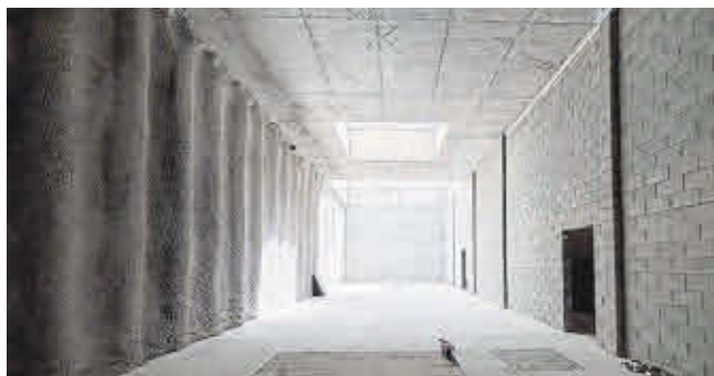
Cuarto técnico. En estas 'salas' es donde irán diferentes sistemas que hacen que el túnel funcione, como la ventilación. Cada kilómetro y medio de túnel hay dos de ellos.
